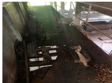
Gambar 9. Peralatan pada stasiun threshing
