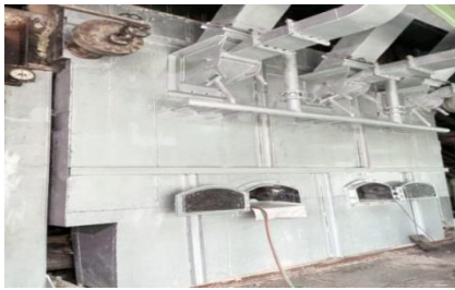
Gambar 1. Boiler pada Pabrik Kelapa Sawit
