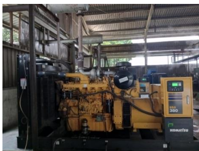
Gambar 2. Generator Set di Pabrik Kelapa Sawit
