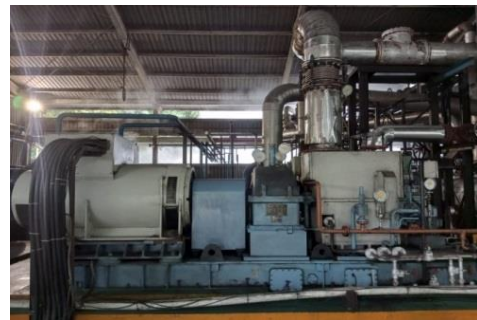
Gambar 3. Turbin Uap pada Pabrik Kelapa Sawit
