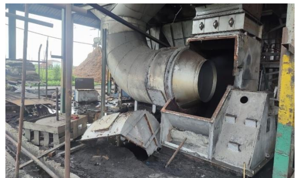
Gambar 3. Kondisi IDF Setelah mengalami kerusakan
